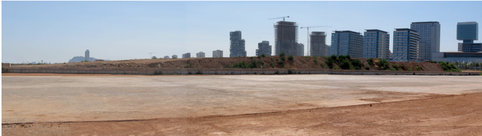
La construcción del nuevo frente marítimo en el Poblenou – Barcelona (Fuente: Isabel Arteaga /2008)
